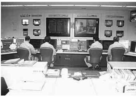
清掃工場の中央制御室
