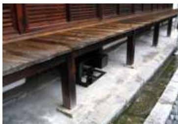
縁の下に設置した放水銃
