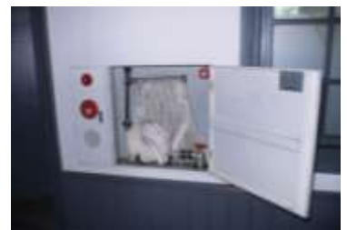
壁埋込式消火栓
