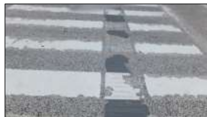
【エスコートゾーンが摩耗している】
