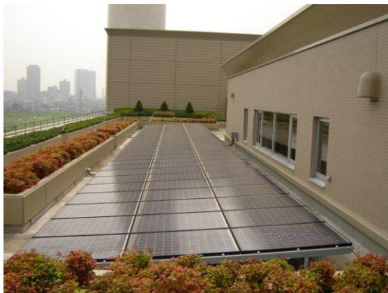
太陽光発電パネル（多摩川清掃工場）
