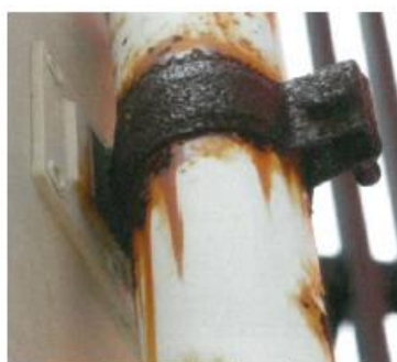
腐食（判定Ⅲ）
