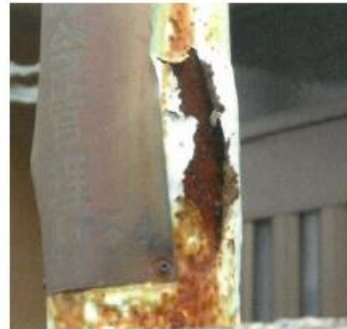
腐食（判定Ⅱ）
