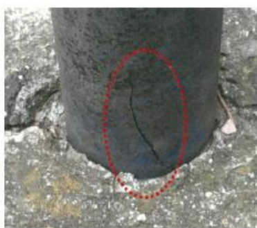
亀裂（判定Ⅱ）
