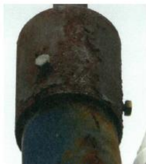
腐食（判定Ⅲ）
