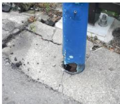
腐食による穴（判定Ⅲ）
