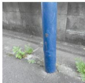
腐食による変形（判定Ⅲ）
