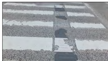
【エスコートゾーンが摩耗している】
