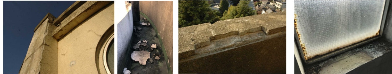
外部の劣化及び破損(外壁仕上げ材の剥離と外部建具枠からの浸水)
