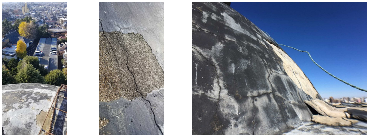
ドームの破損状況(ヒビ割れと仕上げ材の剥離)
