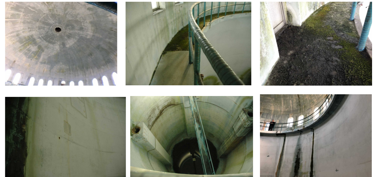
内部水槽部の劣化状況
