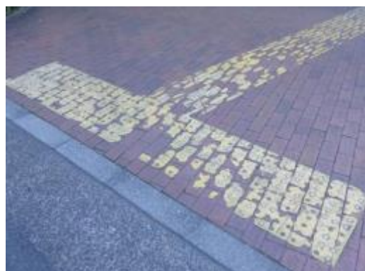
誘導用ブロックの摩耗、劣化
