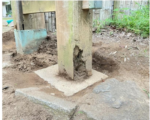
控柱の腐朽状況
