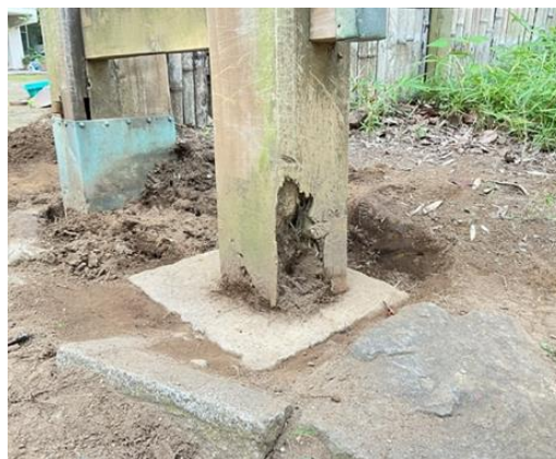
控柱の腐朽状況
