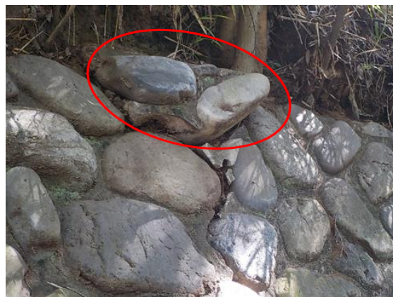
石積のせり出し状況
