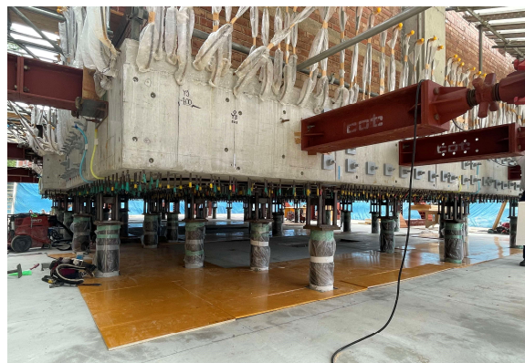
写真4 正門直下の状況
