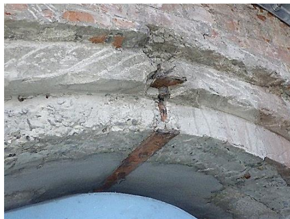
写真4 受付窓上部の取り付け跡
