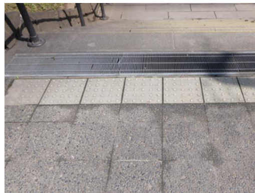
誘導用ブロックを黄色のブロックに改修してほしい
